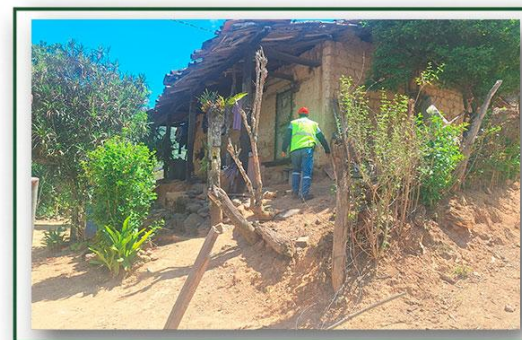
Verificación de necesidades de servicio eléctrico y repotenciación
